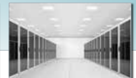
Structure de serveurs centralisée
